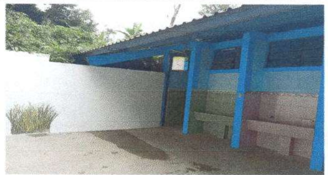
Foto 6: Se han quitado las puertas en servicios sanitarios
